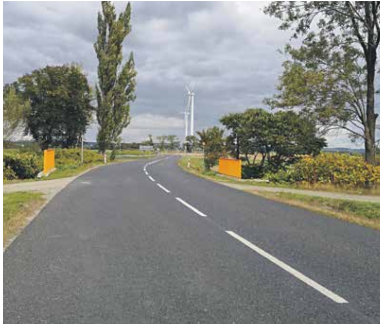
Droga nr 382 od Paczkowa do granicy państwa jest rozbudowana już od kilku lat. Teraz przyszedł czas na jej kolejny odcinek. Fot. UM Paczków
